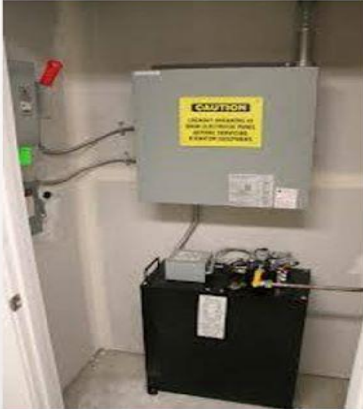
إمكانية فصل التيار الكهربى يدوياً عن المصعد من داخل غرفة الماكينات
